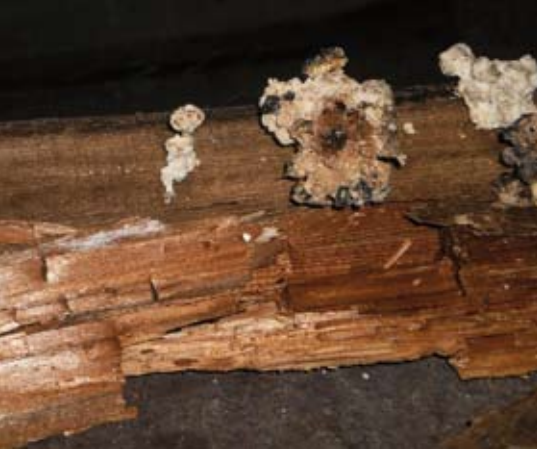
Gomba termőtest a födémdeszkázaton
